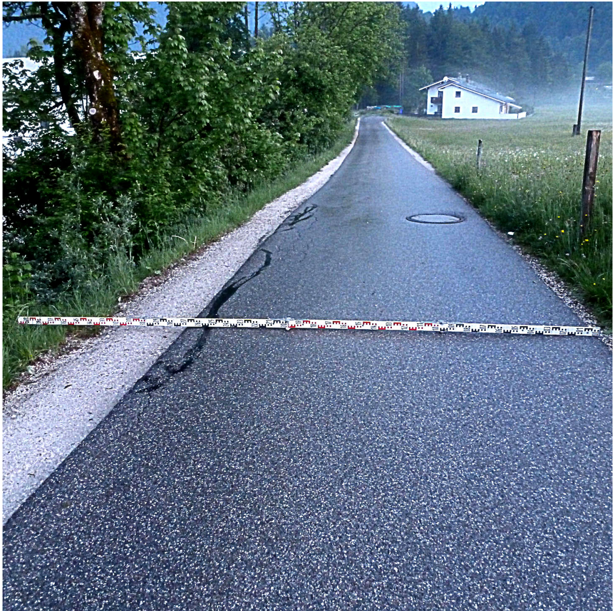
Abb. 1: Der Meterstab ist 4 Meter lang. Wie zu erkennen ist beträgt die Asphaltbreite ca. 2,70 Meter, bei 3,60 kippt das Fahrzeug die Böschung hinunter. Der Gutachter behauptet die gesamte Fahrbahnlänge sei 4,00 Meter breit.
